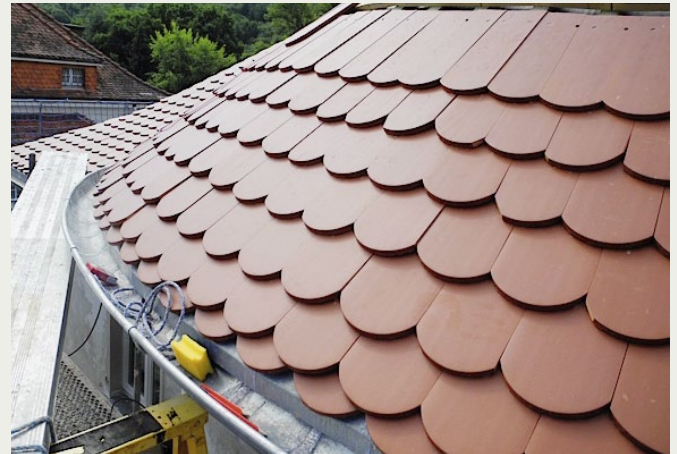
Am Turm musste jeder Biber im Kopfbereich konisch zugeschnitten werden. Um die Deckrichtung einzuhalten, wurde ein Draht vom First bis zur Traufe gespannt. Für die Sturmsicherheit wurden Klammern eingebaut.
